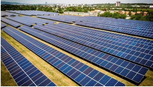
Prostostoječa sončna elektrarna (zajem zaslona/Deloindom)
