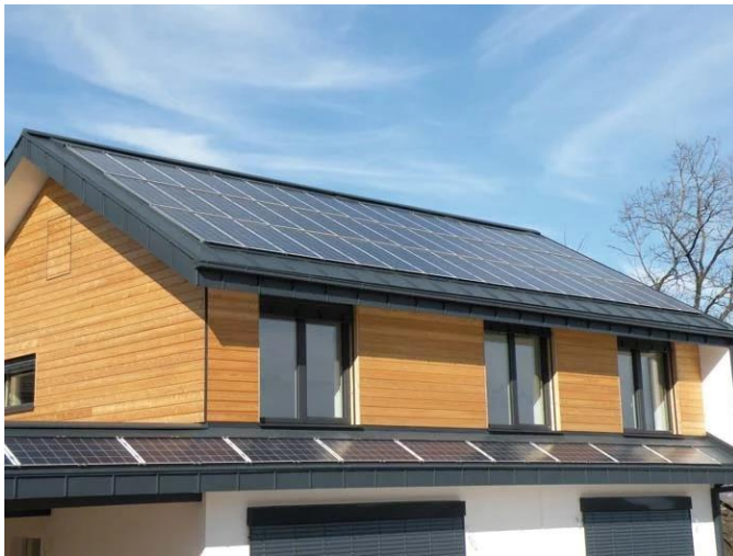
Integrirana sončna elektrarna (zajem zaslona/Varčujem z energijo)
